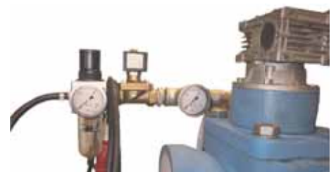
Die Abbildungen zeigen den Rückspüladapter im Einsatzfall im Vergleich zur alten Variante als Leitungssystem.
